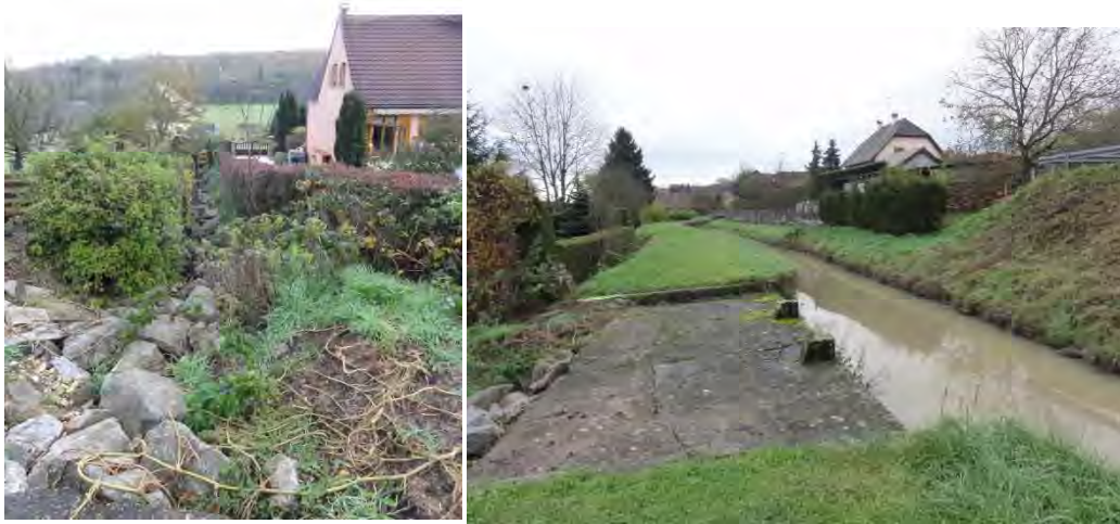
Figure 33 : Exutoire contraint en secteur urbanisé à Strueth destiné à recevoir les eaux débordantes de la rigole (à gauche) ; déversoir de la rigole à Strueth (à droite).
