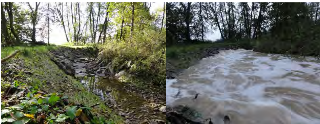
Figure 29 : Déversoir de crue sur la Largue à Dannemarie à sec hors période de crue (à gauche) et en période de crue (à droite).
