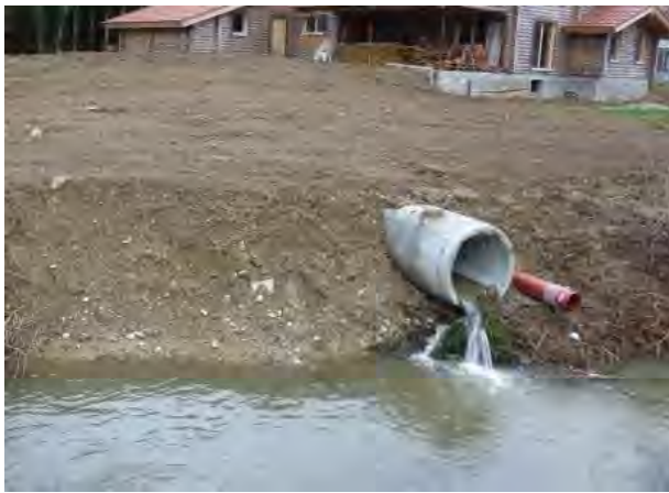
Figure 28 : Arrivée directe dans le Traubach d'un fossé busé en passage de la zone urbanisée
