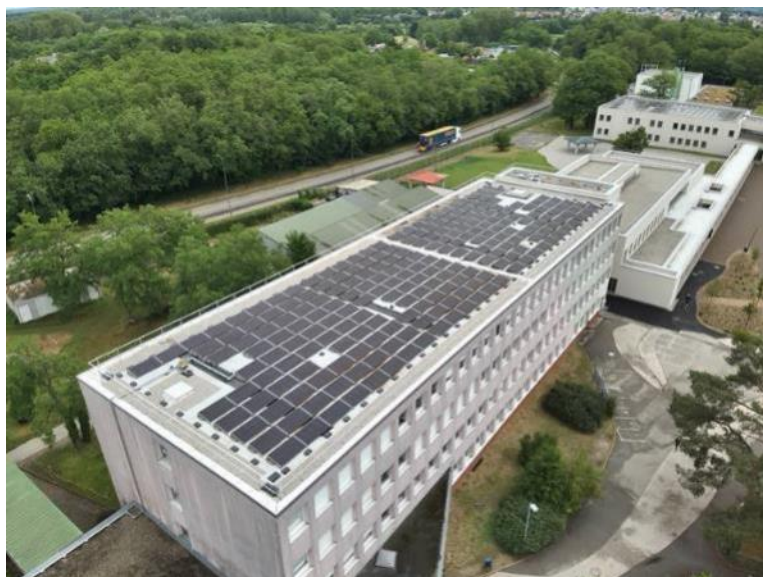
Photo 2: Cité scolaire de BISCHWILLER. Puissance installée de 314 kWc, 1 528 m 2 de panneaux mis en service en juin 2025, pour un coût total de travaux photovoltaïque de 397 994 € HT.
