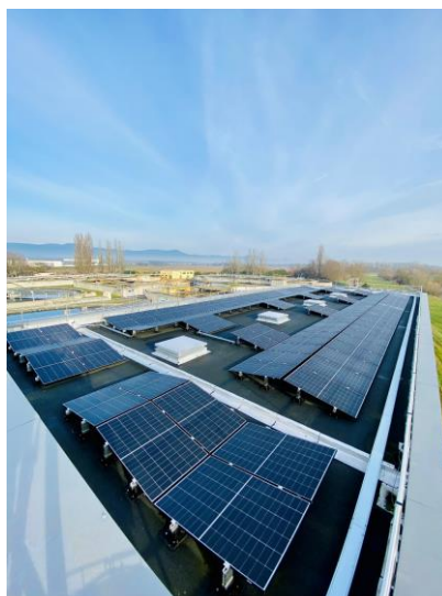
Photo : VEOLIA – station d'épuration de Colmar
