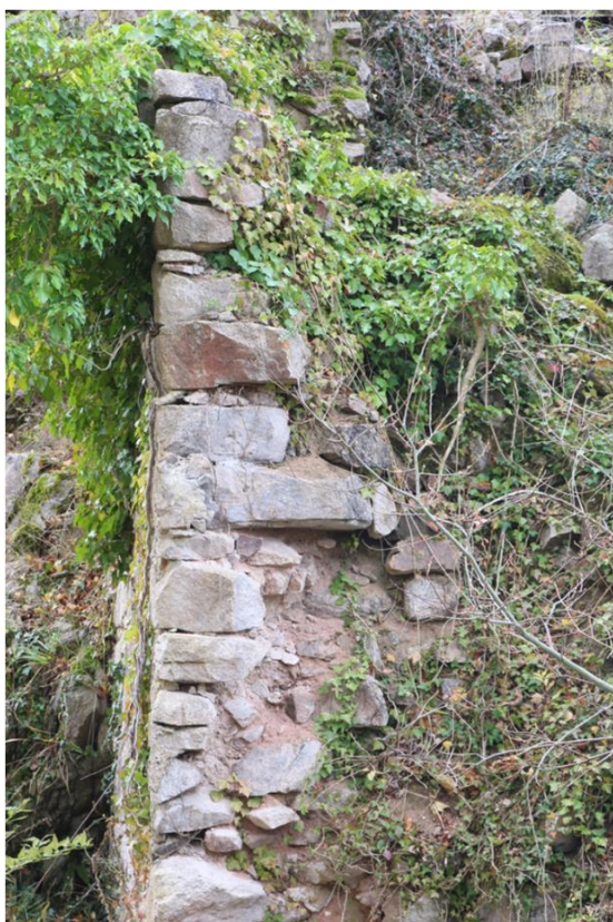
Arrachement dangereux au Landsberg coupe sur arrachement montrant le blocage altéré et même absent
