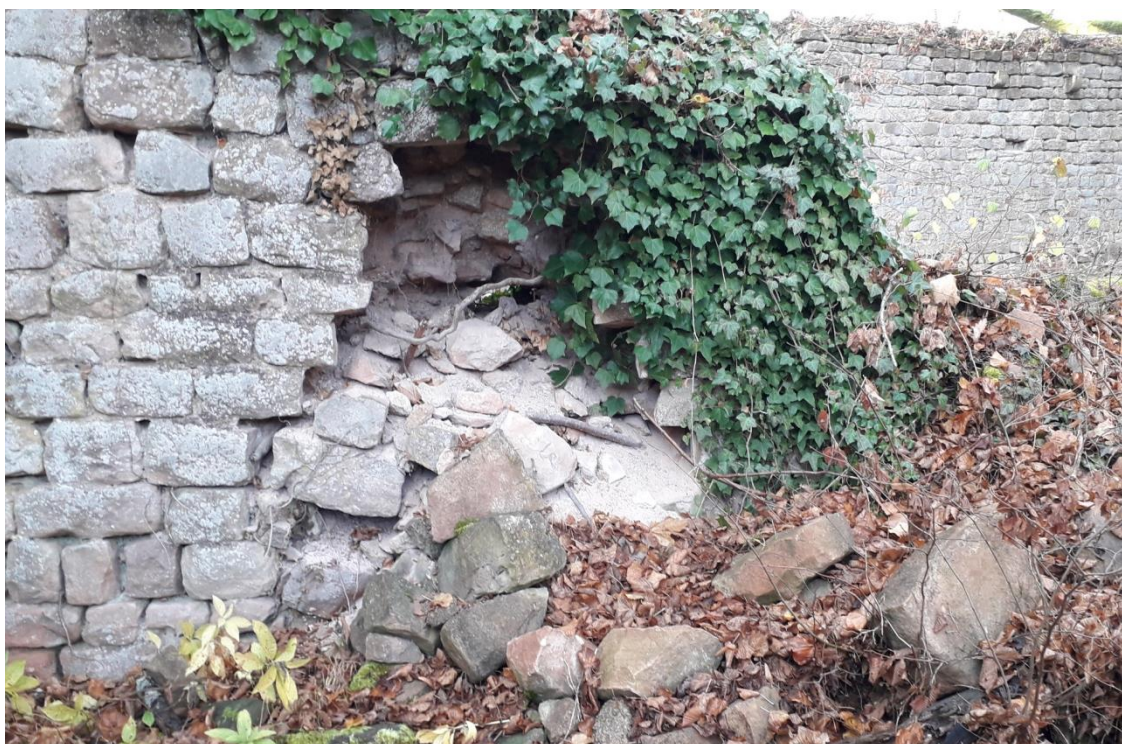
Landsberg : effondrement de mur, avec important porte à faux. Le public marche par-dessus cette niche instable.
