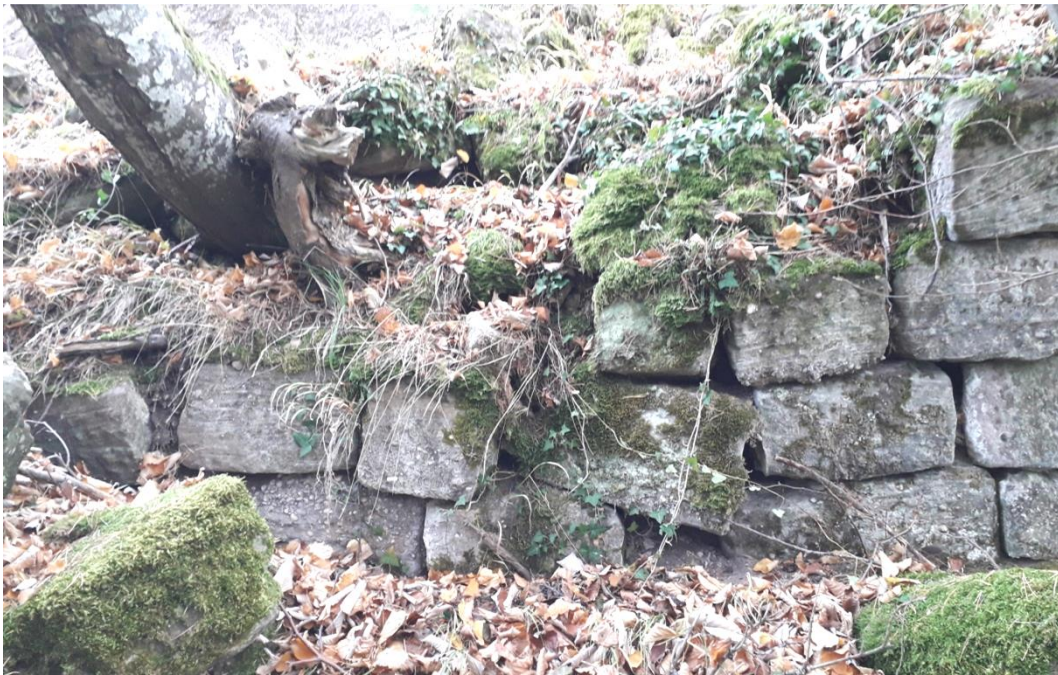
Dreistein : la totalité des parements hors sol sont ici en péril, d'autres parties du mur sont récemment ruinées Seule la dépose-repose intégrale des élévations hors sol, à l'identique, assurera ici leur survie.
