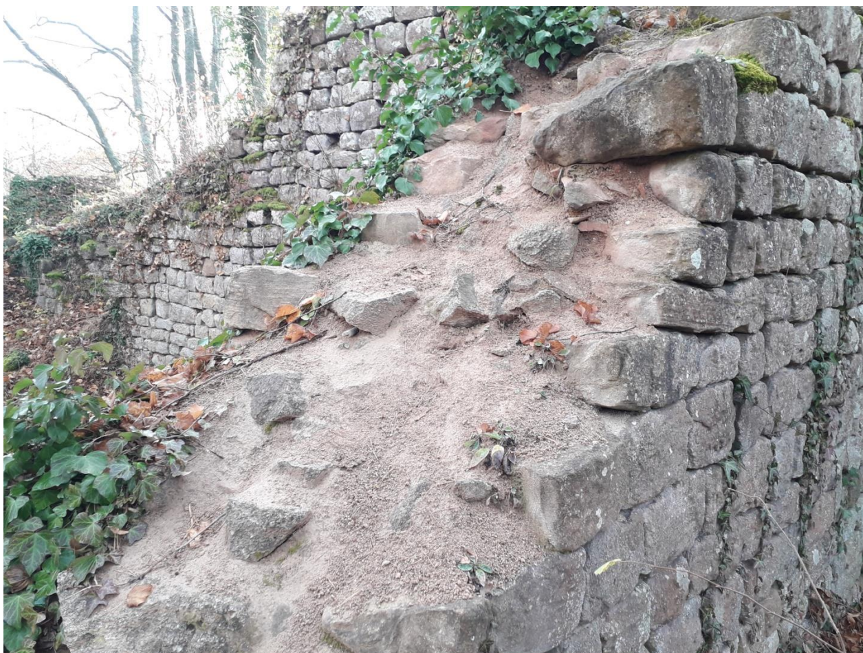
Landsberg : mur très dégradé, soumis au passage de visiteurs, donc dangereux, et perdant sa substance jour après jour.
