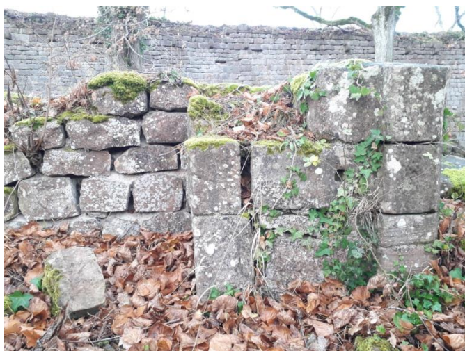
Landsberg : reste de porte en péril (état 2020)
