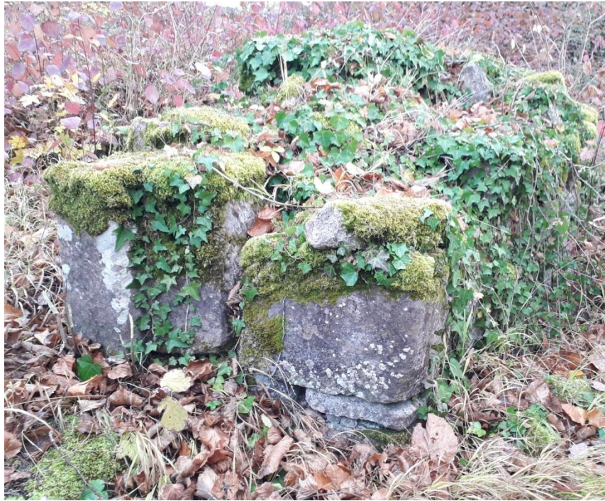
Landsberg : autre embrasure de porte en péril avancé, nécessitant dépose/repose intégrale
