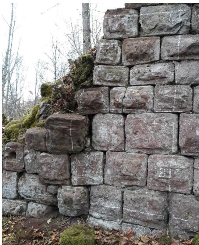
Nideck : arrachement de mur en péril, suite à la croissance d'un arbre derrière le parement. Une quinzaine de blocs sont ici à déposer et reposer pour cicatriser ce mur
