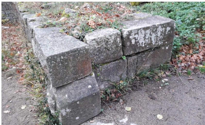
Landsberg : porte en grand appareil régulier, non lié, légèrement déchaussé La dépose/repose des parements et la réalisation d'un rocaillage assureront sa pérennité
