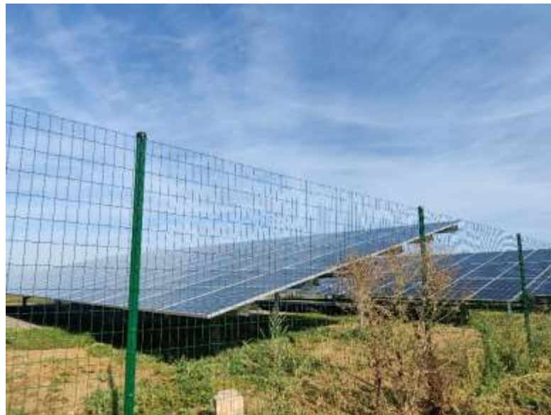
Installation photovoltaïque de Munchhouse (Source : Collectivité européenne d'Alsace ENGIE PV)
