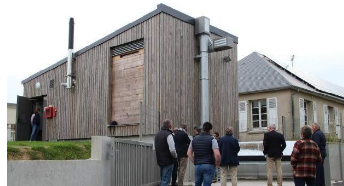
Chaufferie bois, Hamdye 120Mwh, 113 mètres de réseau, alimente 1 groupe scolaire, la Mairie, 3 logements municipaux.
