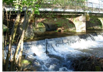
Seuil infranchissable du pont de la RD 1422 sur l'Andlau à SAINT-PIERRE
