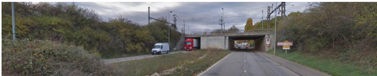
Fig.22 Zone d'infiltration sur la RD105 à l'Ouest de l'ouvrage sous SNCF
