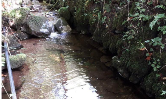
Erosion du lit du cours d'eau, et en conséquence, une altération de la fondation du mur.
