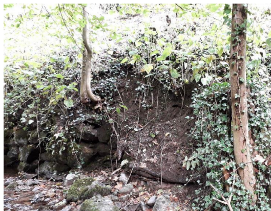
Effondrement d'une partie de la maçonnerie.
