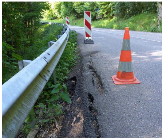
Affaissement et fissures sur la chaussée.
