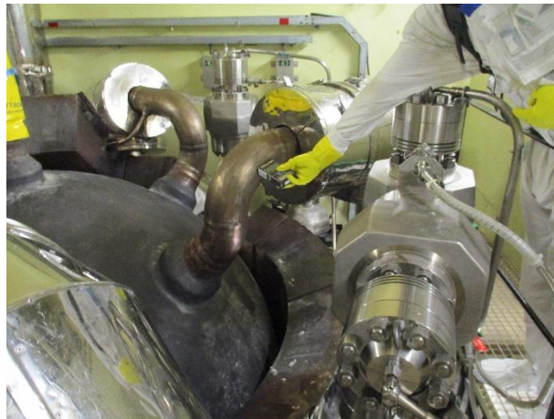
Partie supérieure du pressuriseur
