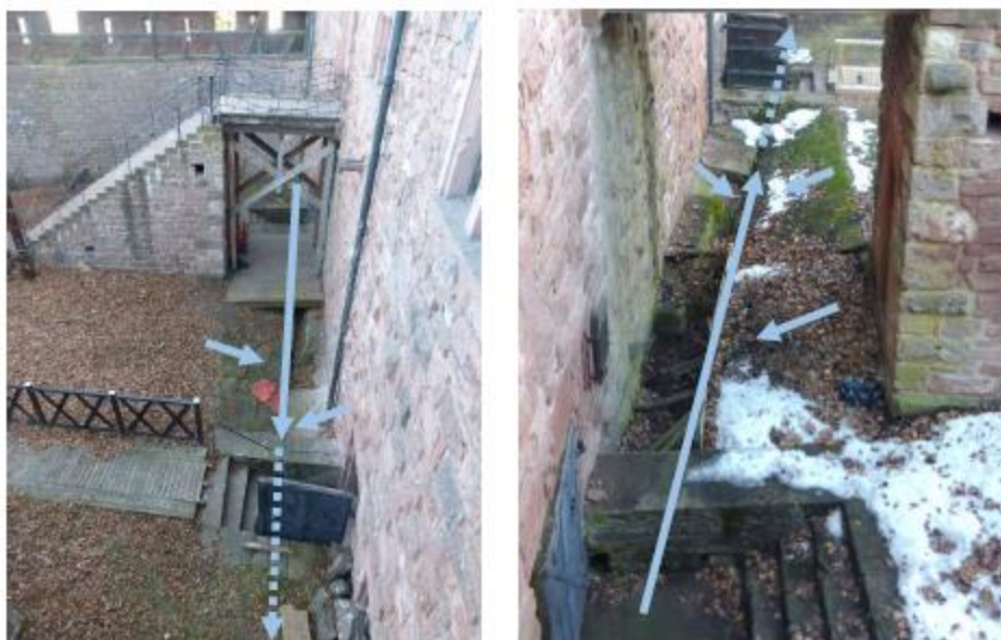
Descente d'eaux pluviales du Grand-Bastion et caniveau le long de la façade
