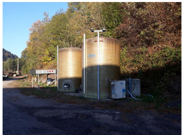
Cuves à saumure
