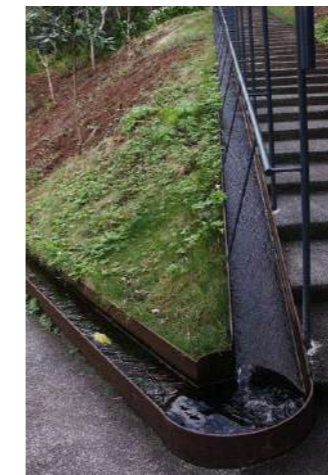
Caniveau de récupération des eaux de pluie pour irrigation
